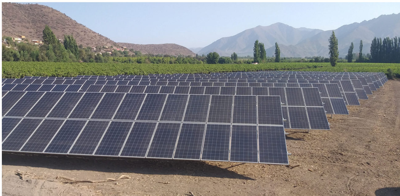
Agrícola Campos Sudamericanos - Planta Fotovoltaica 300kw ubicado en San Felipe, Valparaíso
