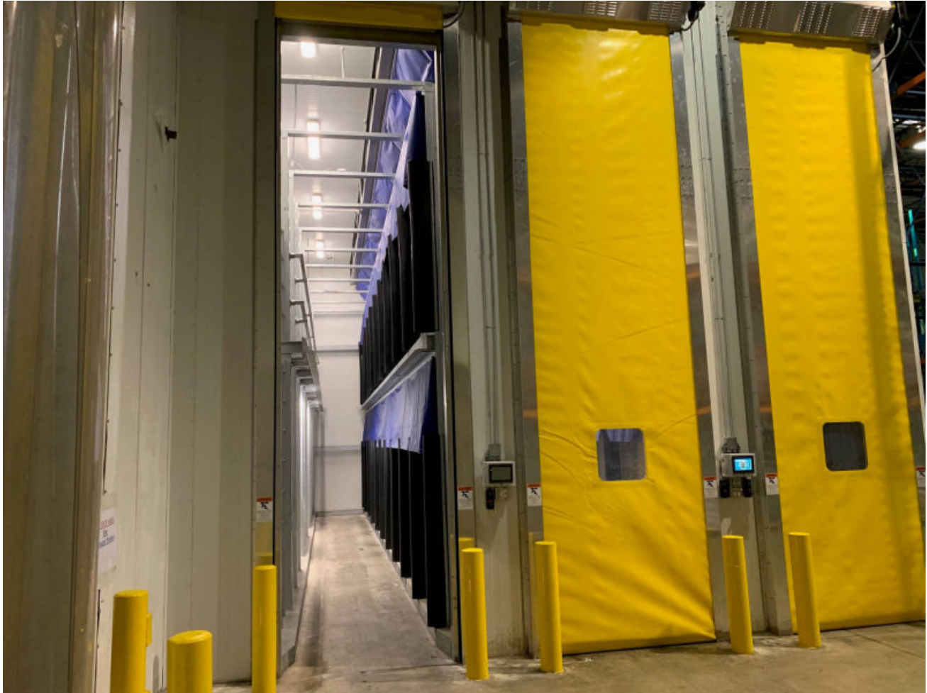
Cámaras de maduración de aguacate.
